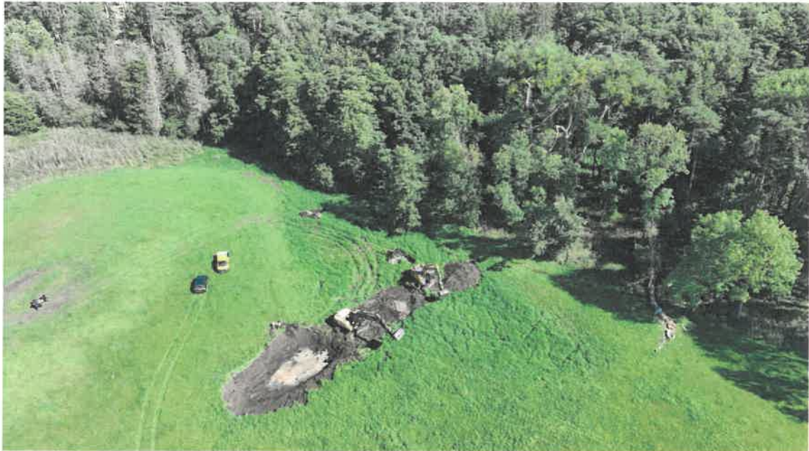
Abb. 6: Maßnahmenstandort M9, in diesem Falle tonunterlagerte Senkenbereiche in Acker- und Wiesenflächen. An den Standorten M5, M8, M9, M28 und M29 wurden Maßnahmen durchgeführt, um die Wasserrückhaltung in diesem Senken zu erhöhen und möglichst auszudehnen. (Foto: L. Schulz)
